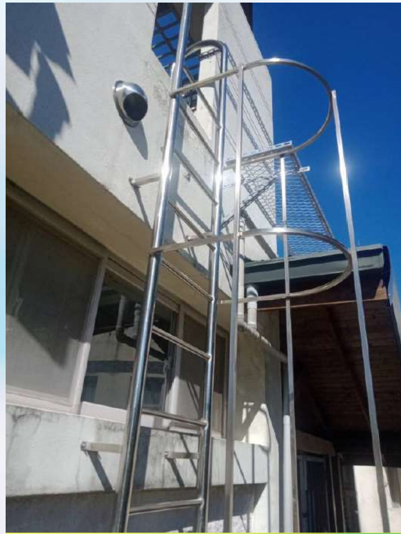
已設安全上下設備
