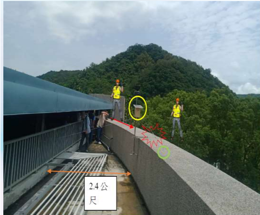
沿女兒牆行走欲拿取放在女兒牆上的電動起子, 惟跨越雨量觀測器時失足墜落。
