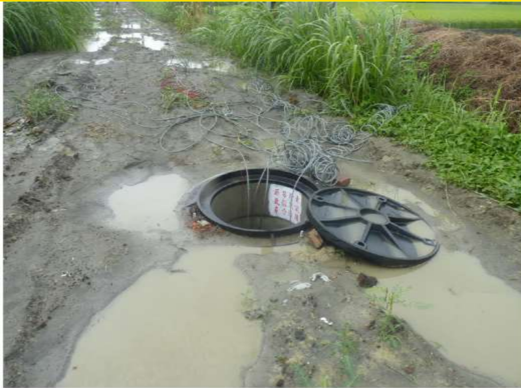
災害當天欲藉棉繩綁鋼索將電纜拉到定位
